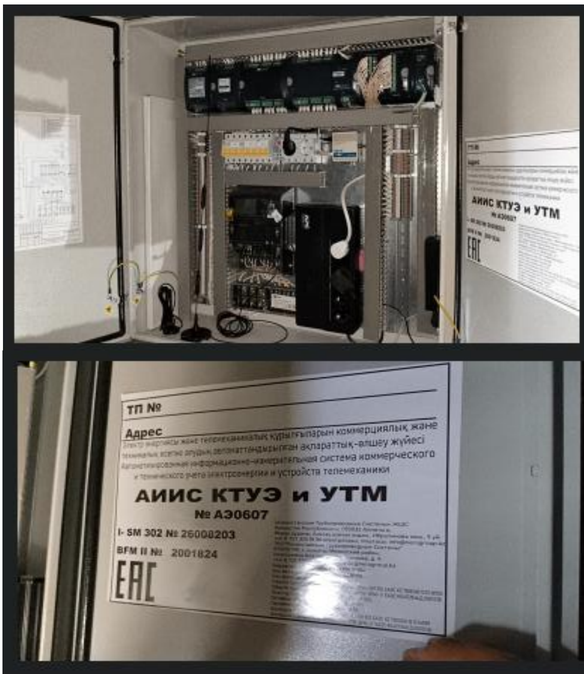
Шкаф АИИС КТУЭ и УТМ - 1 комплект.
